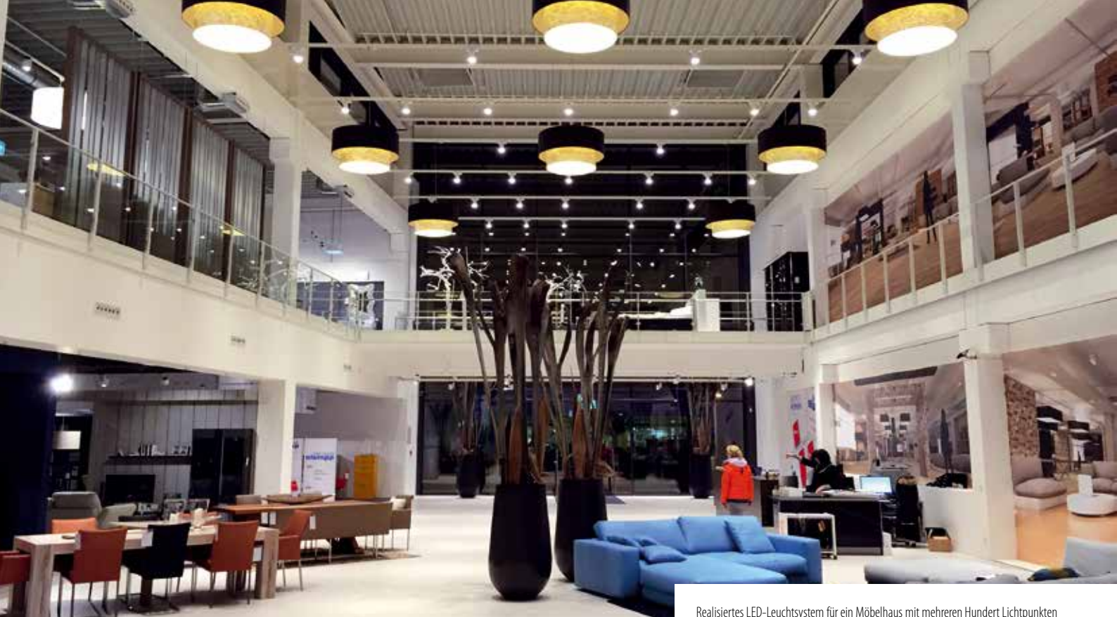
Realisiertes LED-Leuchtsystem für ein Möbelhaus mit mehreren Hundert Lichtpunkten
